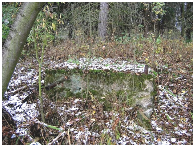
Nádržka na vodu
